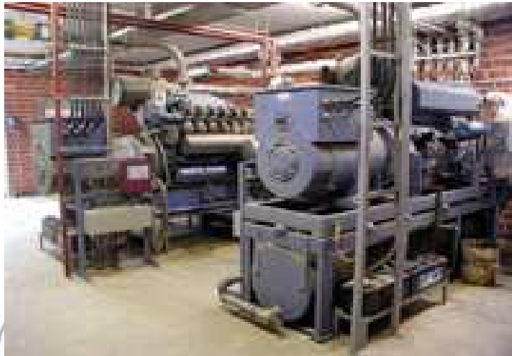
BHKW 2 mal 170 kW
